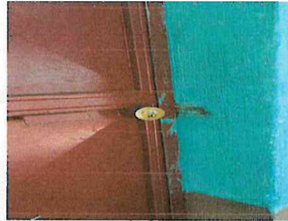
Foto 2: sustitución de chapas pues algunas están sobadas y ya no agarran llave y están flojas.
