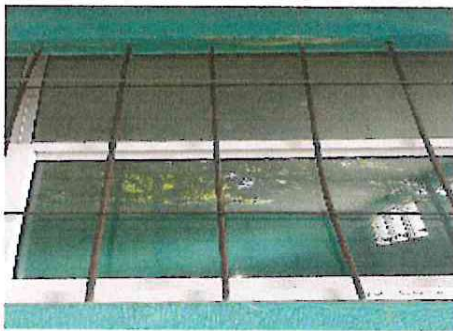
Foto 3: sustitución de estructura de metal de ventana pues en algunas ventanas están en mal estado.
