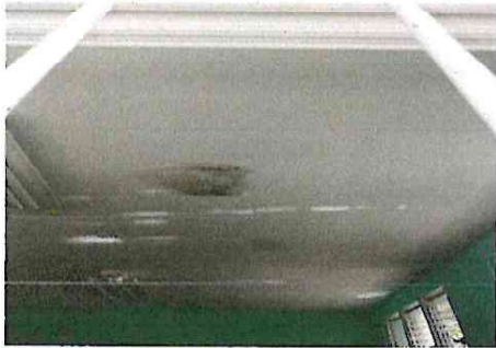
Foto 1: sustitución de lámina pues tenemos goteras que han roto el cielo falso.
